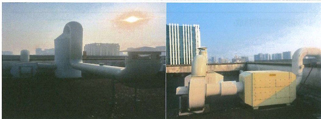
图 3-3 废气处理设施现场照片
