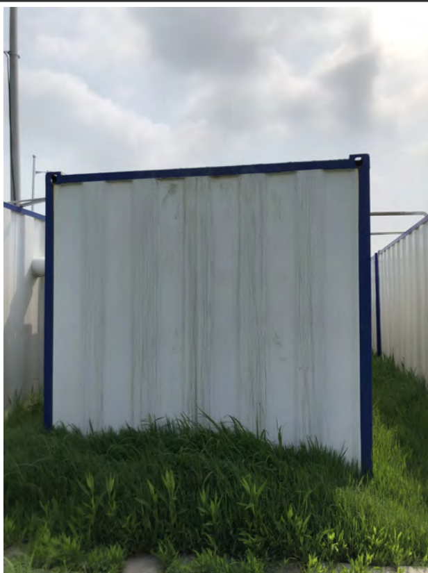
一体化污水处理设施
