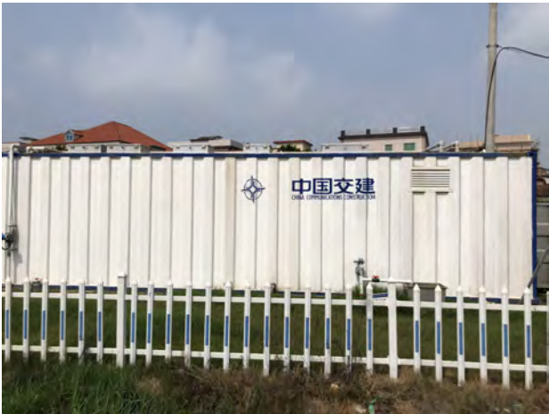
密闭污水处理设施
